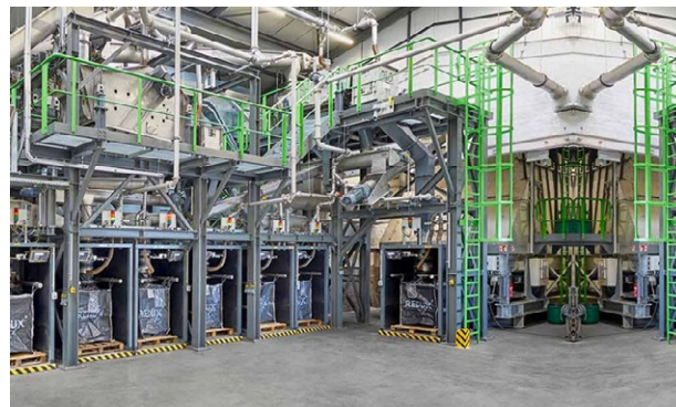
Anlage zum Batterierecycling bei der REDUX Recycling GmbH
